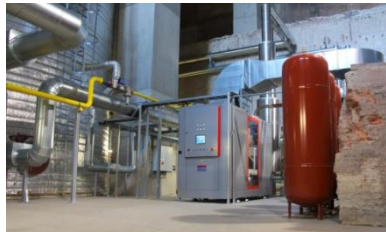
Biomethan/Erdgas BHKW 1.000 kWth/750 kWel
