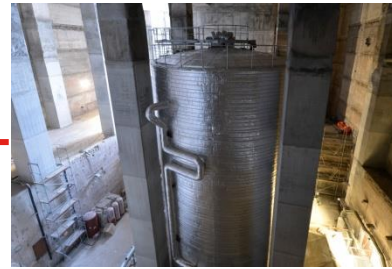
Pufferspeicher (Schichtspeicher) Volumen: 2.000 m 3 Kapazität: 65 MWh
